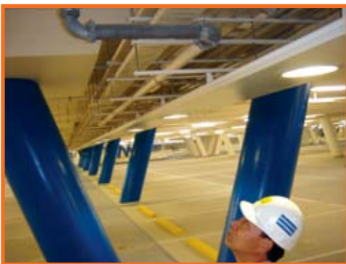
Feuerschutzleitung – Festival City, Dubai, UAE
